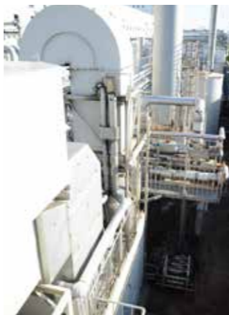
Cogeneration system (Kariya plant) コジェネレーションシステム(刈谷工場)
